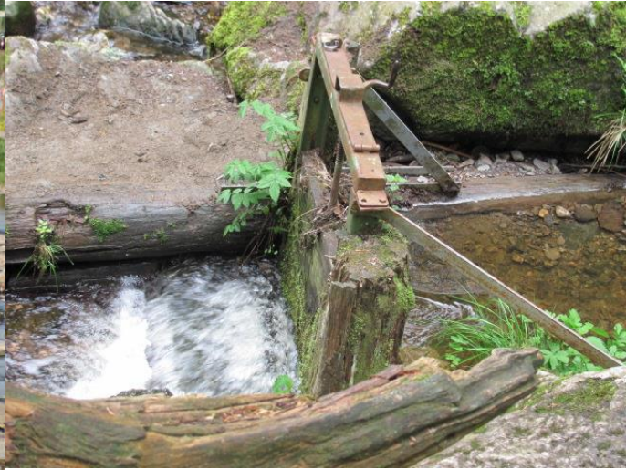
B1-1-b: Wasserleitungen aus dem Schwarzwald mit Wasserstandregulierungsmöglichkeit, Quelle: Bömicke, ©Bömicke
