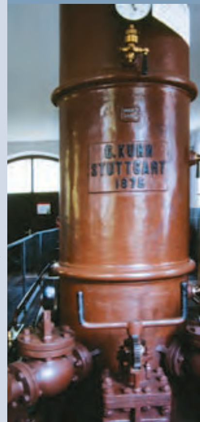
Pumpe im Pumpwerk Blaubeuren
